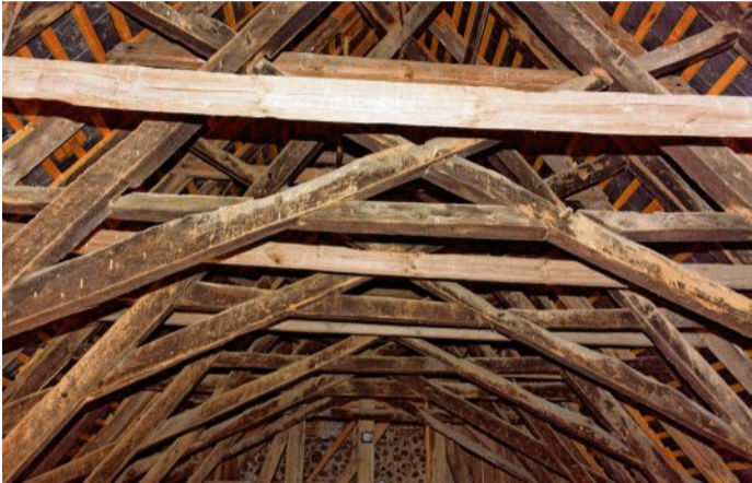
Innen und außen braucht der nachträglich aufgesetzte Turm der über 700 Jahre alten Kirche eine Generalüberholung.
