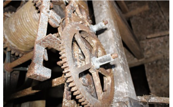
Das Uhrwerk ist seit Jahrzehnten defekt. Nach der Sanierung soll auch die Kirchturmuhre wieder funktionieren.
