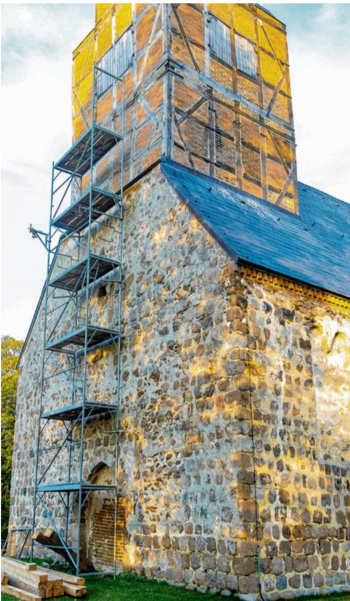
2018 musste der Turm notgesichert werden. Jetzt besteht Hoffnung auf eine Sanierung, die mehr als eine halbe Million Euro kosten würde.
