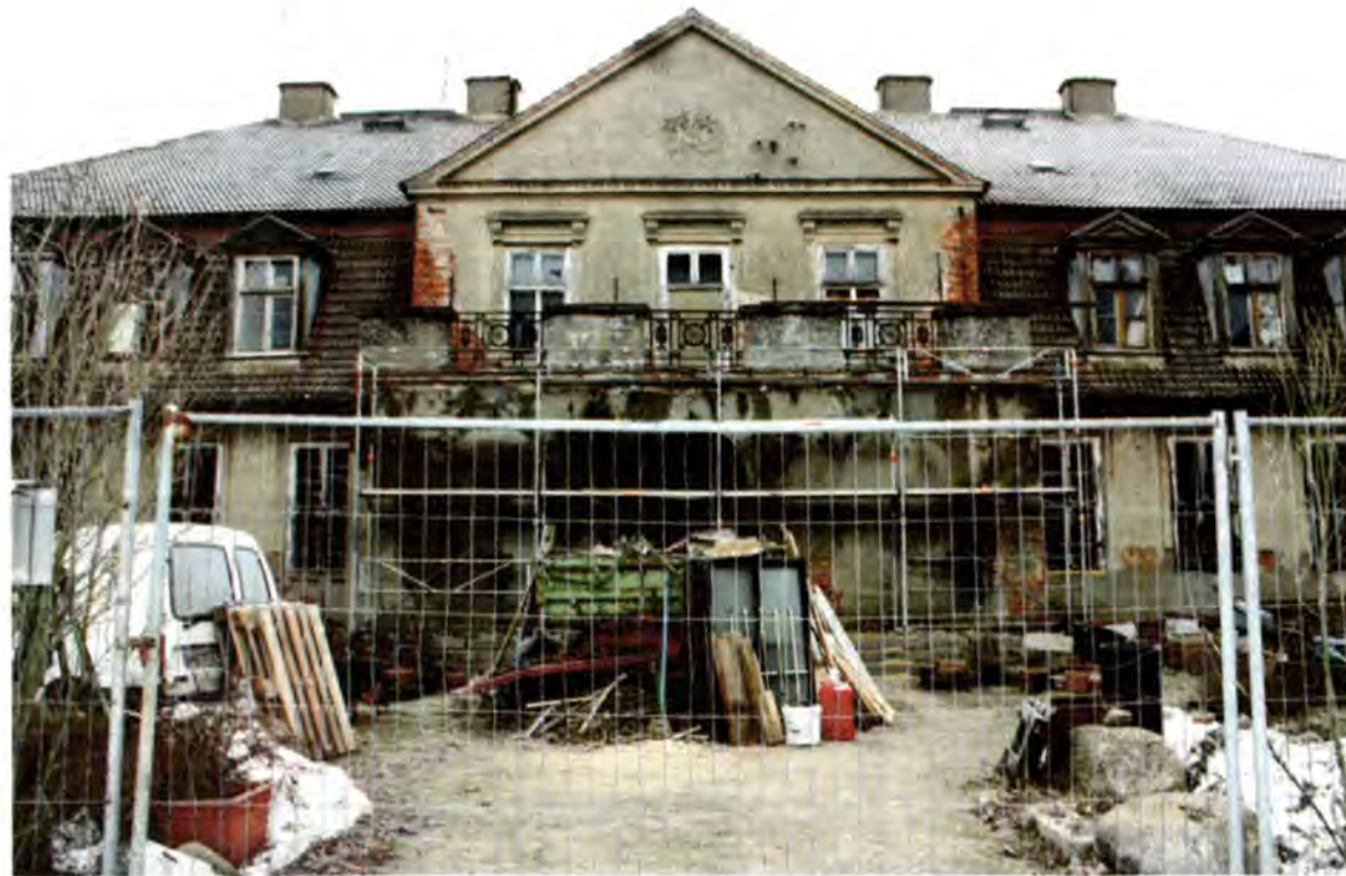
Der Eigentümer des Ganzkower Gutshauses hat seit 2004 so gut wie nichts zum Erhalt des Gebäudes getan. Die Untere Denkmalschutzbehörde will nun Maßnahmen festlegen.
